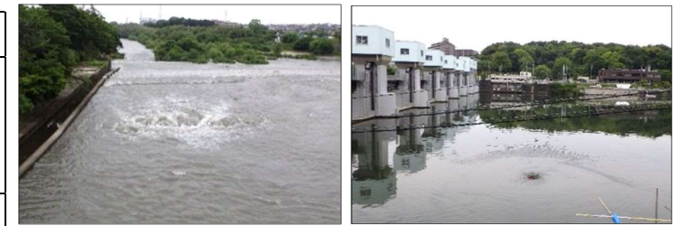
漏水発生状況(5月17日)(左：下流側、右：上流側)
