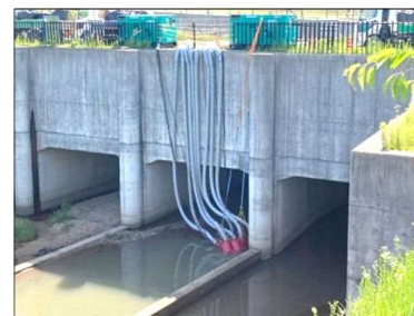
ポンプ設置状況 (5月28日) (豊田市内、新安永川)
