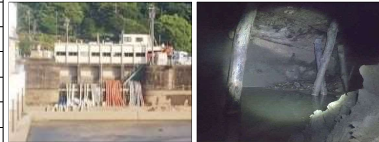
応急ポンプによる取水 (5月19日)
