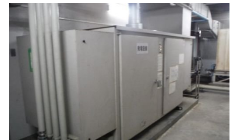
自家発電設備
